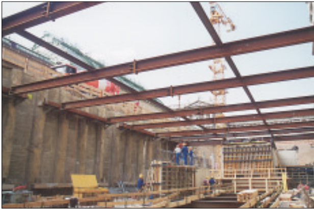
Der Tiefspeicher wird errichtet – das Herzstück wird das autom. Hochregallager sein, welches ca. 90% der Sammlungen aufnehmen wird.
