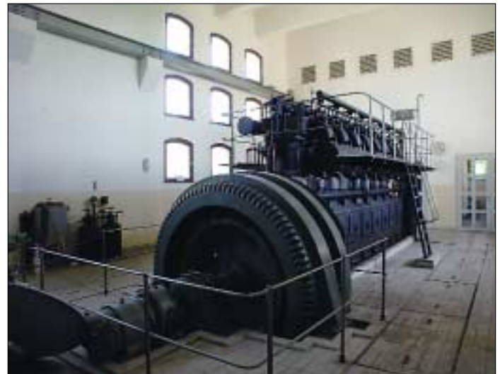
Abb. 3: Sender Dobl, Dieselaggregat
