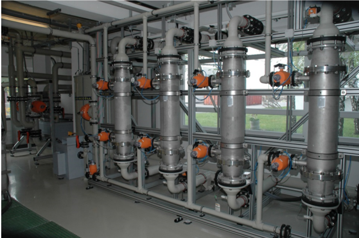
Abbildung 6: Filtriereinheit der Ultrafiltrationsanlage; Bild: © NES GmbH
